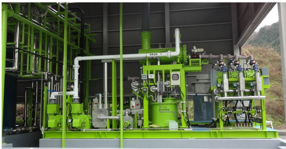
写真 1-3 愛媛県松山市におけるエコ次亜生成装置 5)
