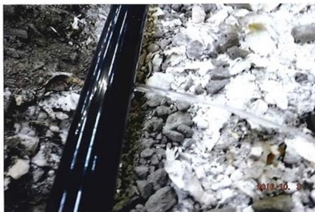
写真 1-4 埋立層内通気・通水管例 10)
