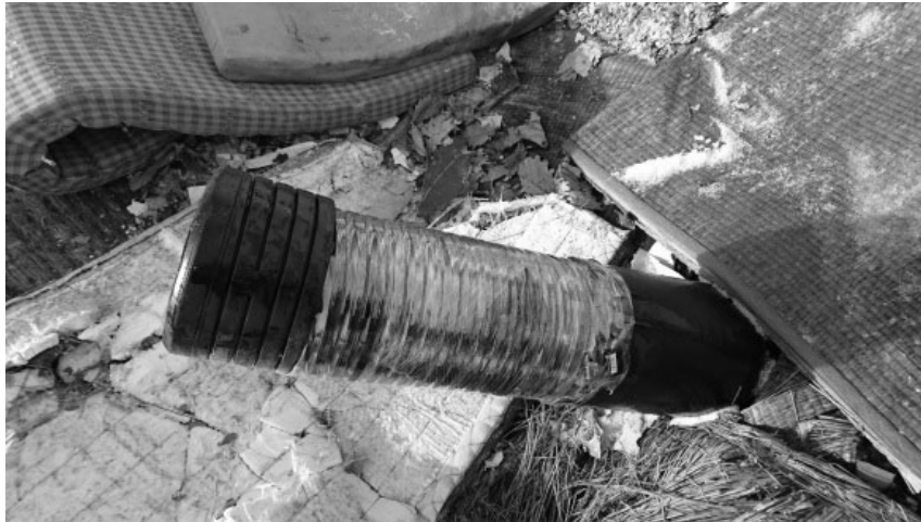
写真 - 2.19 ガス抜き管の密閉状況
