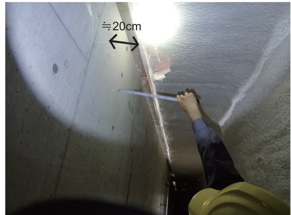
写真 5.1 耐火被覆の剥離
