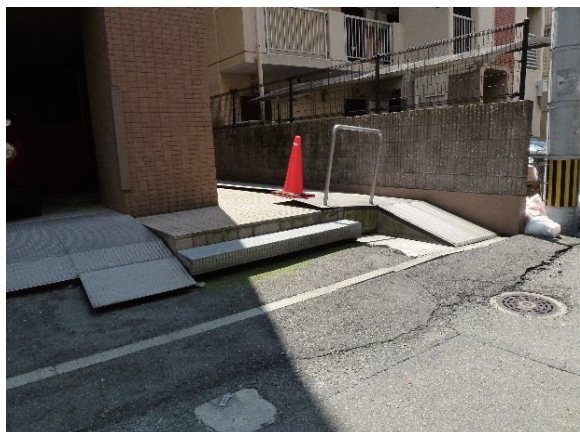
写真 2.17 建物周辺の地盤沈下
