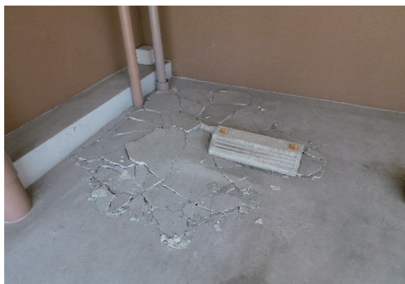
写真 2.18 駐車場床スラブのクラック
