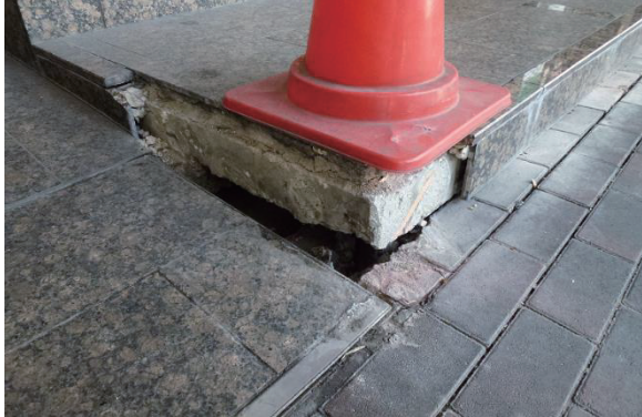
写真 2.8 クリアランスカバーのタイトルの破損
