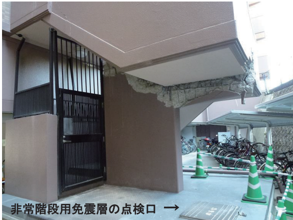
写真 2.13 避難階段の損傷 (b 棟)
