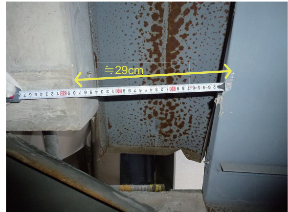
写真 2.15 エキスパンションジョイントの接触痕
