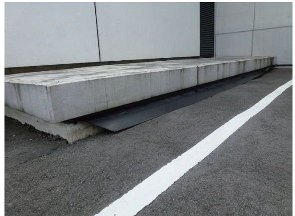
写真 5.2 免震スカートのはみ出し
