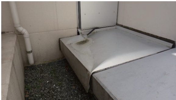
写真 3.2 クリアランスカバーの変状
