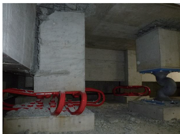
写真 2.19 ダンパー取付け基部及び床スラブの破損
