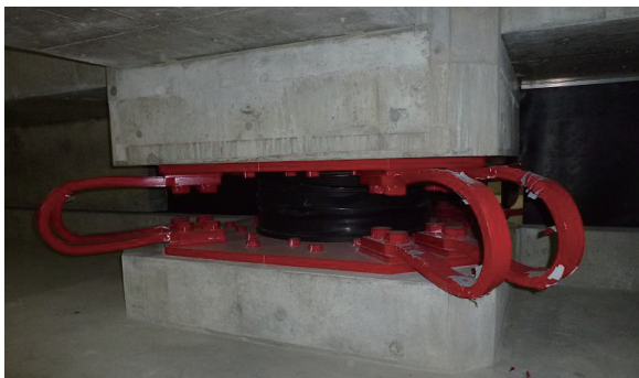
写真 2.4 天然ゴム系積層ゴム支承とU型鋼材ダンパー
