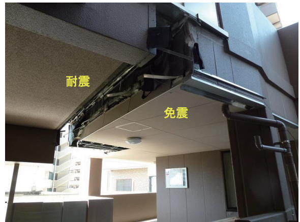
写真 2.11 エクステンションジョイントの破損
