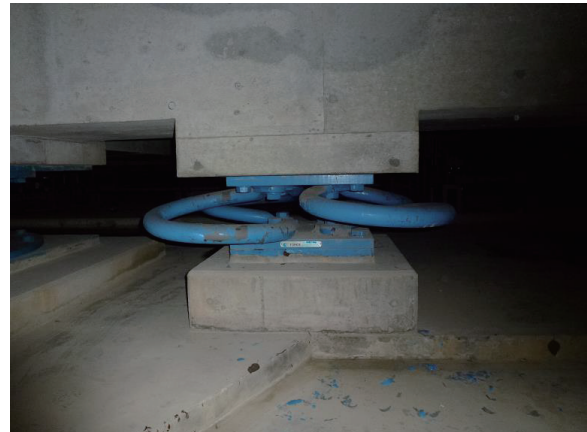
写真 2.3 鋼棒ダンパーの塗装の剥がれ
