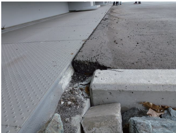
写真 5.4 建物周辺の地盤沈下
