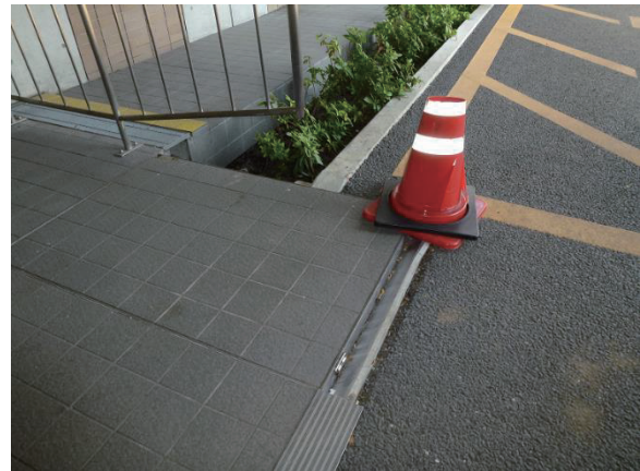
写真 2.2 クリアランスカバーと手すりの変状
