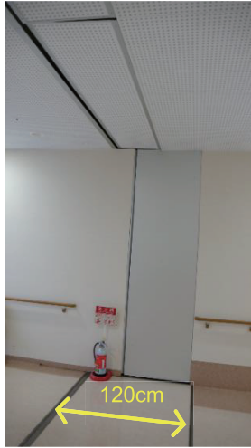
写真 3.1 天井パネルのずれと 室内のクリアランスカバー
