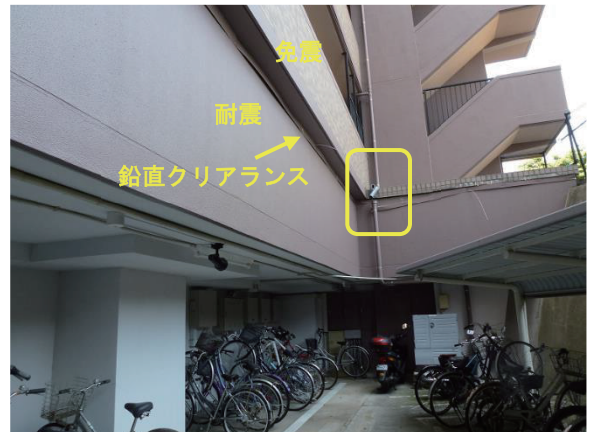
写真 2.12 雨樋の破損 (b 棟)
