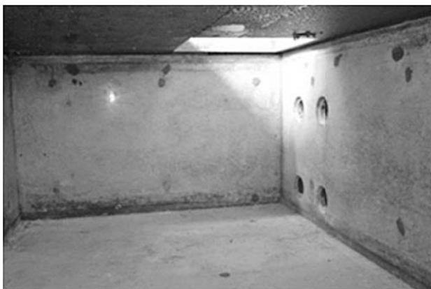
写真-2 基礎を兼用したコンクリート製の第1地下貯留タンク内部
