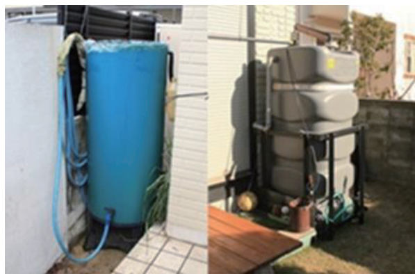
写真-1 樋井川流域内に実装した家庭用雨水貯留タンク 左: 200Lタイプ 右: 1000Lタイプ
