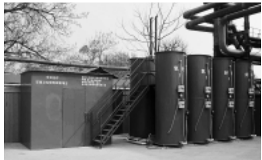
北京の実証設備
