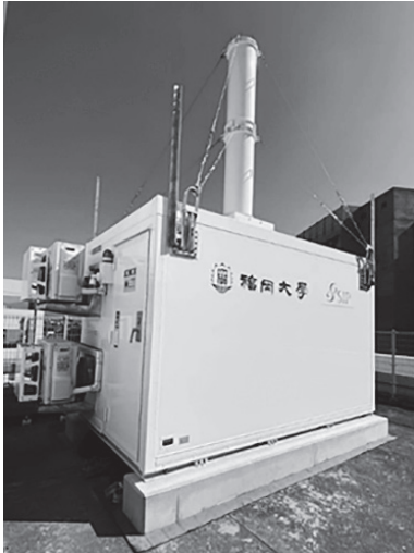
図1：福岡大学18号館屋上に移設した水蒸気ライダーの写真
