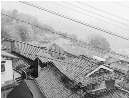
図10 木造家屋の瓦の被害
