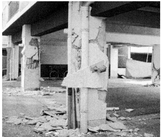
図6 鉄筋コンクリートの被害
