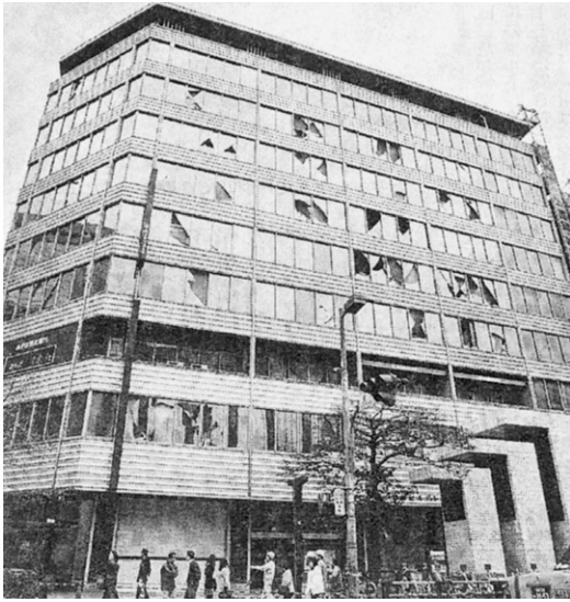
図8 事務所ビル窓ガラスの落下
