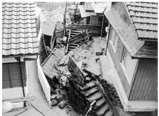
図13 ブロック塀の倒壊
