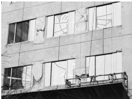
図9 外装材の剥落
